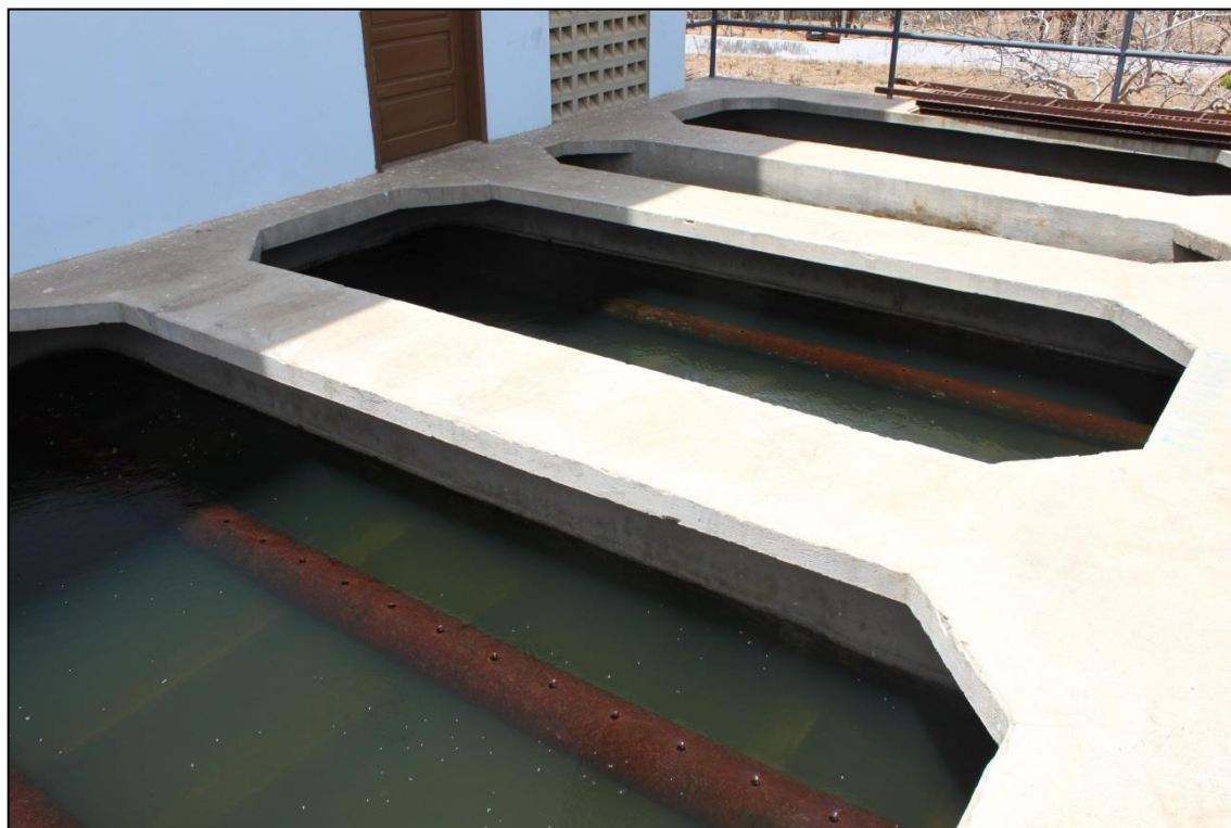
Figura 2.1.4.1.4– Tratamento da água captada – visão parcial.
