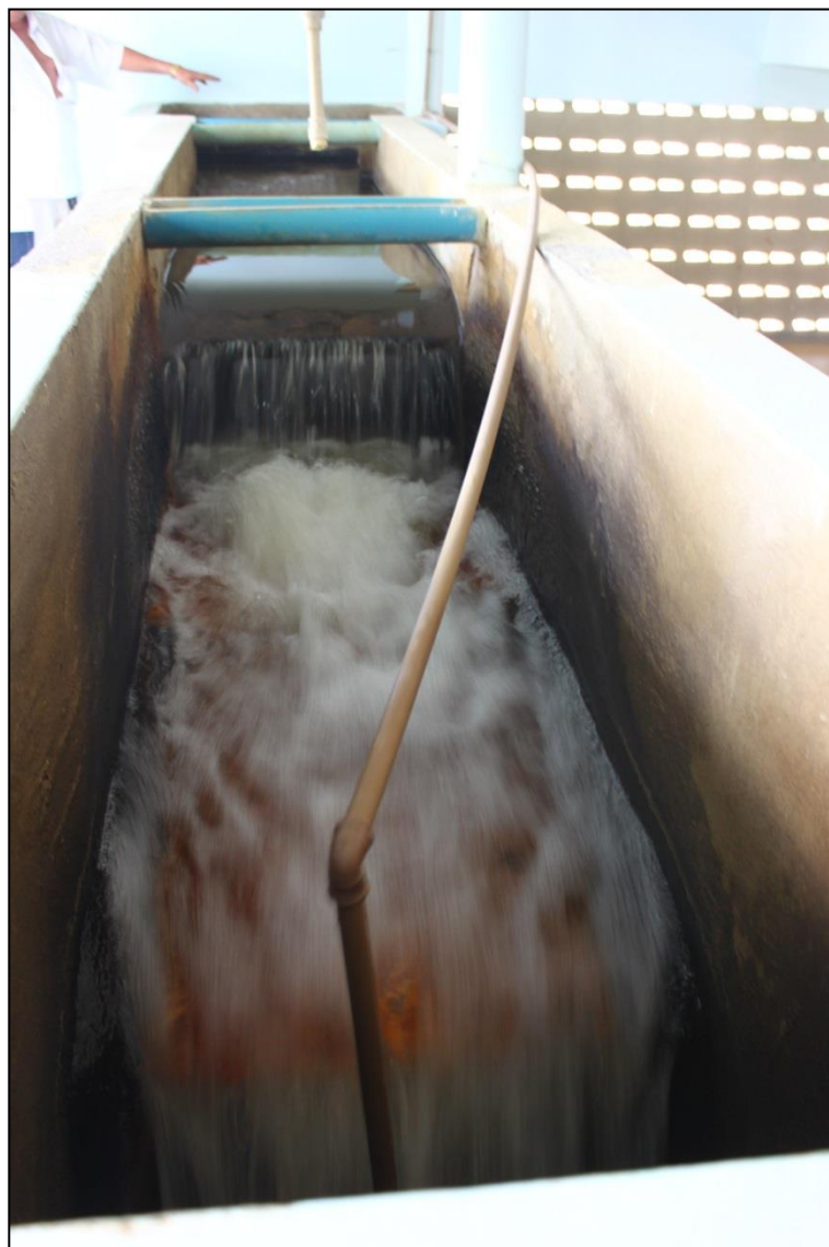
Figura 2.1.4.1.3– Chegada da água a E.T.A.
